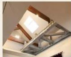
16 蒸気レンガ製の耐震補強の鉄骨水平トラスを見ることができます。
